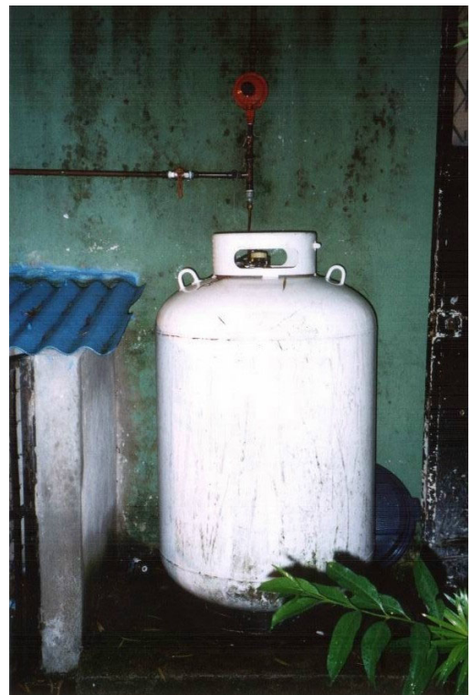
FOTO No. 17 Cilindro de gas propano, capacidad 100 galones, situado en el exterior
