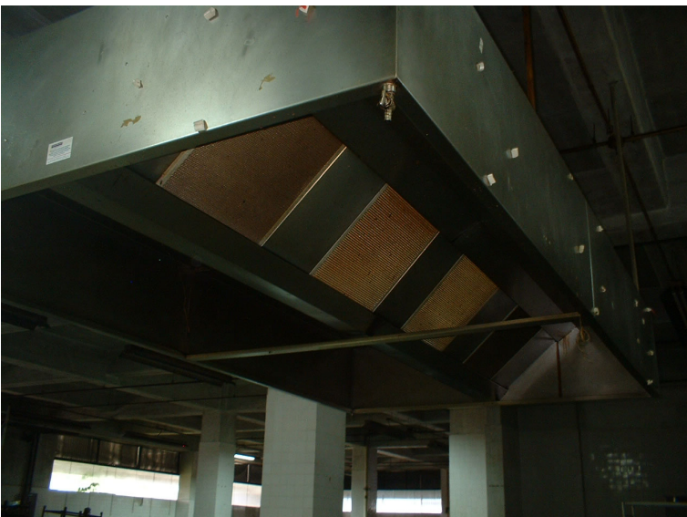
FOTO No. 35 Detalle de una de las campanas de extracción
