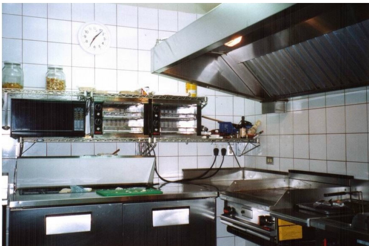
FOTO No. 24 Área para preparación de sándwiches, mesa fría y debajo refrigeradores; en la estantería se encuentran horno microondas y 2 hornos tostadores
