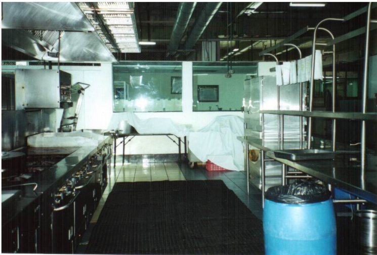
FOTO No. 5 Área de producción de la cocina para banquetes, vista de estufas, planchas, salamandra y estanterías
