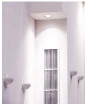
Ilustración No.42 "Rejillas de aire acondicionado" Auditorio Juan Bautista Gutiérrez, UFM
