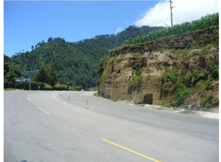
Fotografía No. 27 Cortes de carretera sin tratamiento
